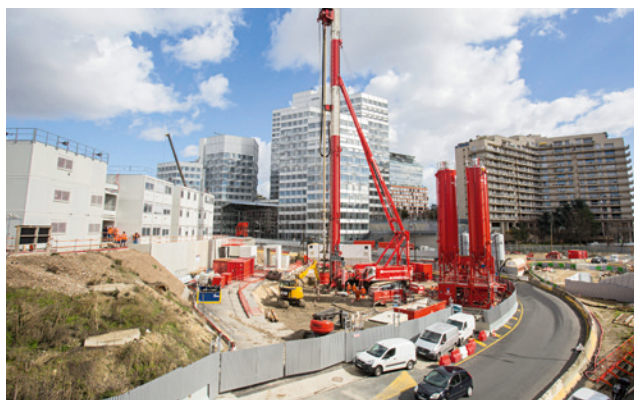
■ Le traitement des sols a été effectué avec la plus grande foreuse d'Europe (traitement Deep Soil Mixing), avant les parois moulées.
